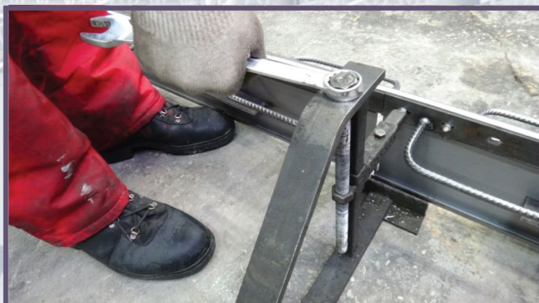
6 С помощью нивелира устанавливаем опалубку в проектное положение, регулируя ключом вертикальное положение
